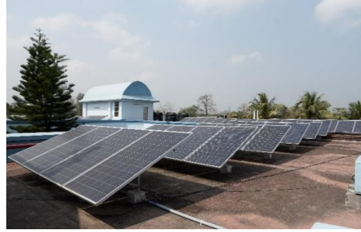
चित्र 2.16 प्रशासनिक भवन के छत पर सौर पैनल
